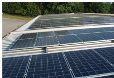
Das Vermarktungszentrum Greinbachhalle setzt damit ein klares Zeichen zur zukunftssträchtigen Nutzung von Sonnenenergie. Die langfristigen Erträge aus der Energieerzeugung werden in die zeitgemäße Instandhaltung der Vermarktungsanlage fließen.
